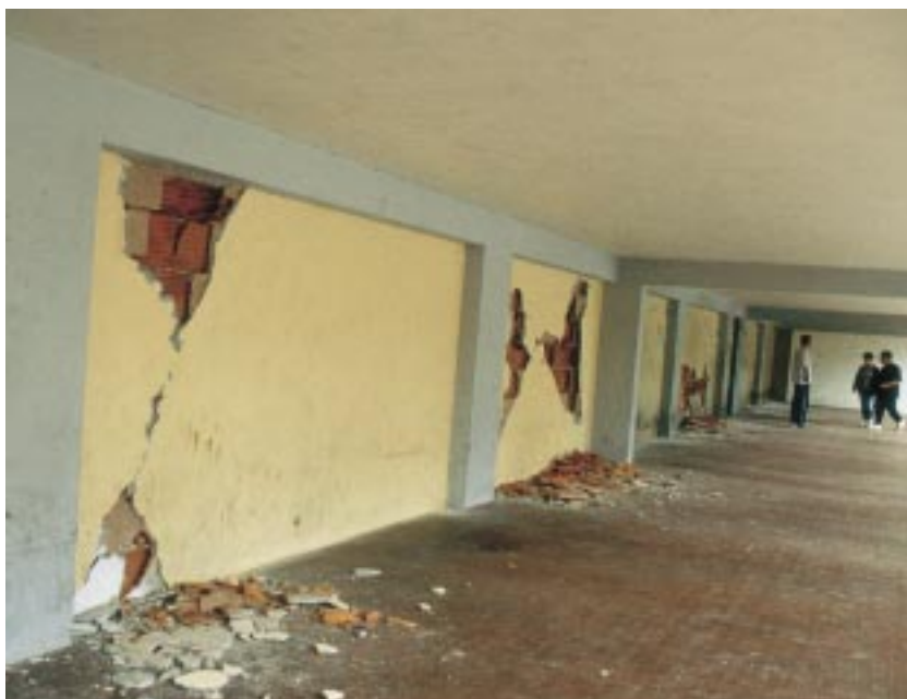
Castelluccio Superiore (Pz): fabbricato danneggiato da terremoto del settembre '98 (Foto O. Chiaradia)
